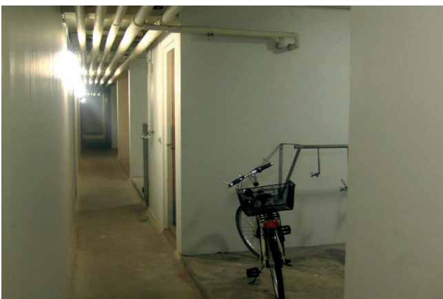
Åbne cykelrum får kælderen til at virke mindre snæver og indelukket. Foto: Marianne Alsing
