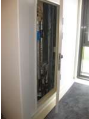
Foto 1. Adgang til boligernes teknikskab fra gangareal udenfor boligen
