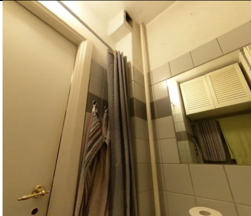
Figur 36: Eksempel på eksisterende aftrækskanal i hjørnet af badeværelse, før reovering.
