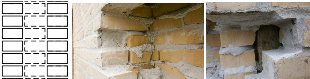
Figur 8 - Billede af undersøgelse af murværk ved Digtergangen. Lindeparken er meget tilsvarende.
